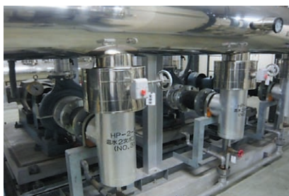
運転制御する温水・冷温水ポンプ群
